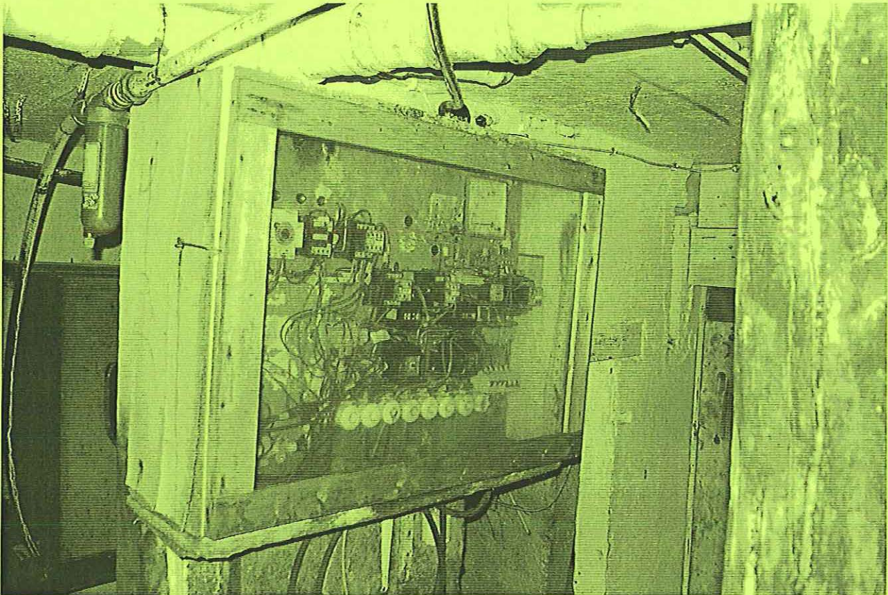
Abbildung 3: Die Steuerung des Kraftwerks im Holzschrank
